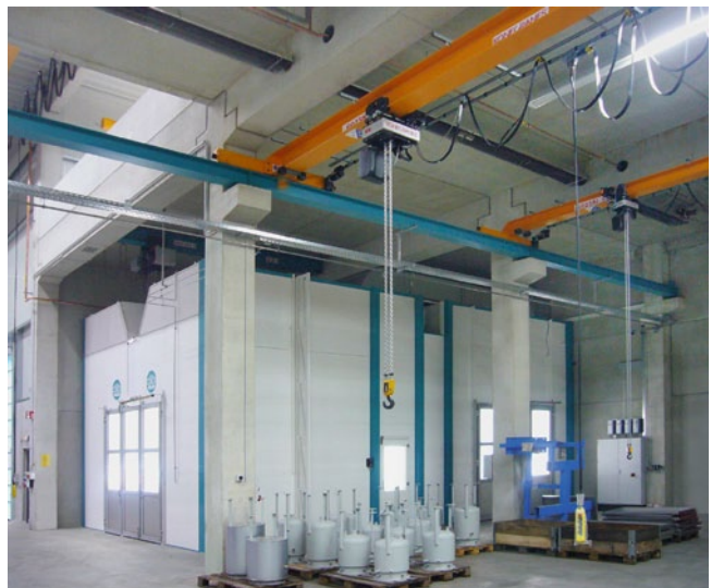
Die Fertigungshalle verfügt unter anderem über eine neue, energieeffiziente Lackier- und Trocknungskabine
