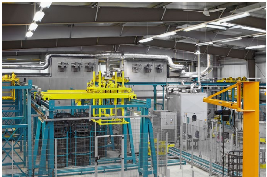
Die neue Gestell-Tauch-Schleuder-Anlage bei Benseler in Markgröningen
