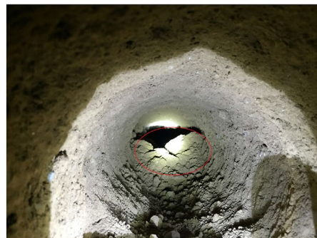
(d) The hole approaching collapse
