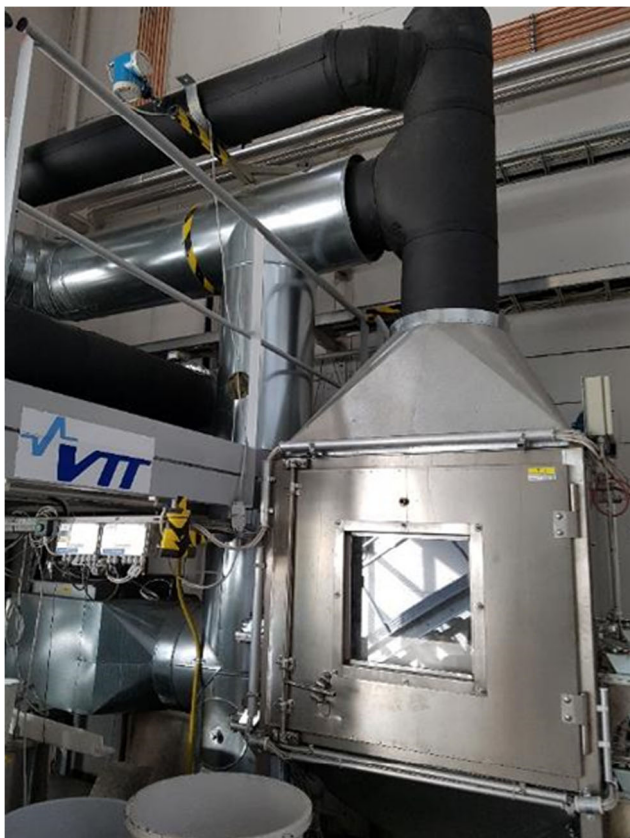
Fig. 3 VTT’s biomass dryer
