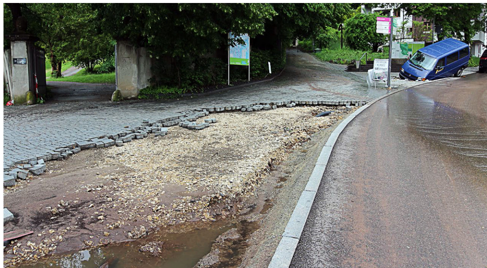
Abb. 2 Schäden durch das Starkregenereignis 2016 in Schwäbisch Gmünd. (Quelle: Stadt Schwäbisch Gmünd)
