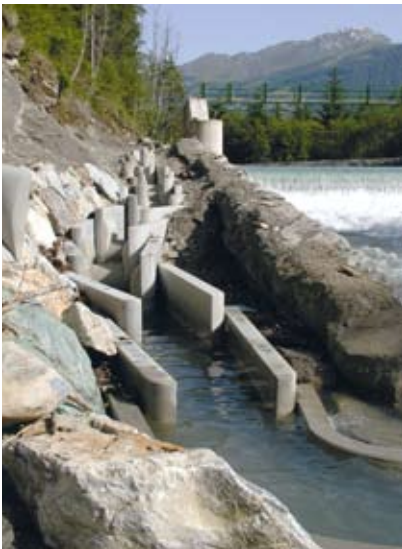
Abb. 4: Fischwanderhilfe, System Beckenpass
