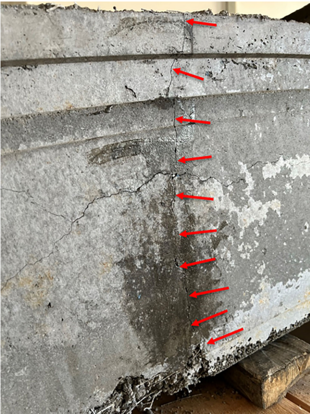
Abb. 2: Riss über die gesamte Tübbinghöhe von FRSpC-T1
