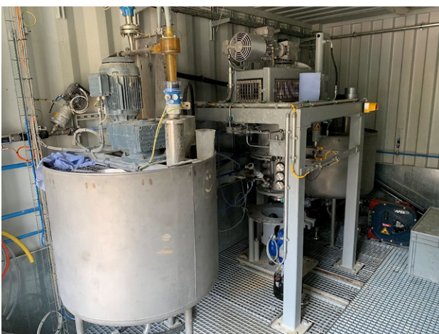
Abb. 1: Gesamtansicht der Mahlanlage im Innenraum des Containers
