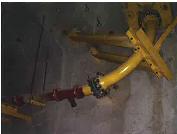
Abb. 2: „Opfer“-Rohrteil eines Versatzsystems [12]
