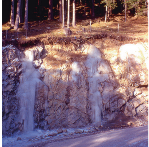
■ Abb. 8.17 Gefrierender Zwischenabfluss an einem Forststraßenanschnitt. In dem Fall hätte wegen des anstehenden Festgesteins bereits ein Anschnitt des Hanges von einem halben Meter gereicht, um eine vollständige Exfiltration des Zwischenabflusses zu erzwingen (Bildquelle: Karl Auerswald)
