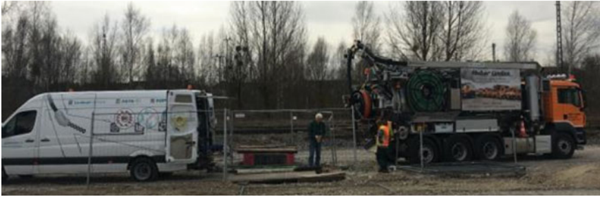
Fig. 7.12 Test setup in Munich. (JT Elektronik)
