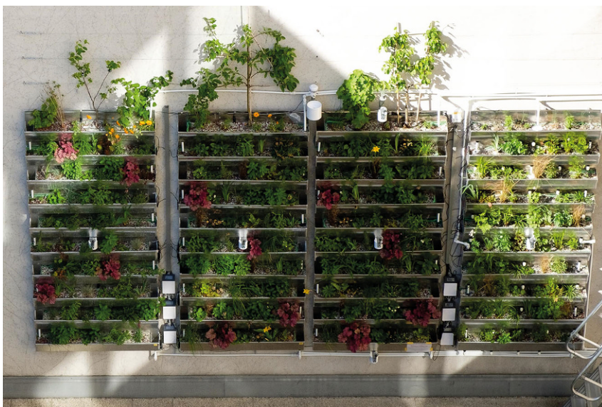
Abb. 3 Vertikales Begrünungssystem zur Reinigung und Wiedernutzung von Grauwasser (Versuchsanlage mit 6 m x 4 m, Universität für Bodenkultur Wien). (Foto: Bernhard Pucher)
